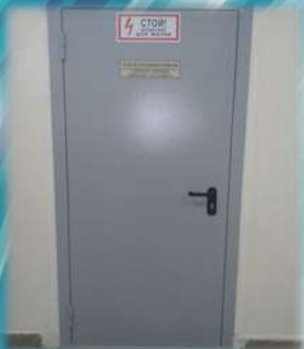
Противопожарная дверь электрощитовой
